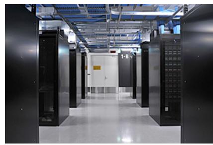
データセンターのサーバールーム内部の様子。100ラックごとのモジュール設計になっており、最大4,000ラックまで増設することができる
